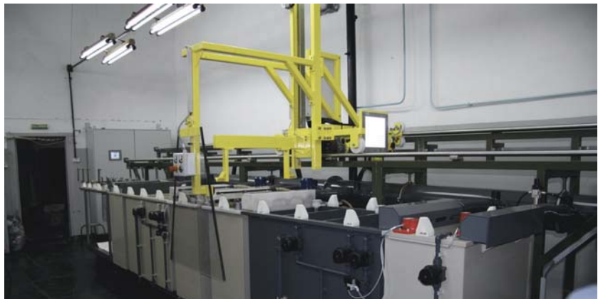
Der Umsetzer (gelb) ist im Sinne des Gesetzes eine Krananlage; das Bild zeigt einen 2011 von ERNE realisierten Chromautomaten.
