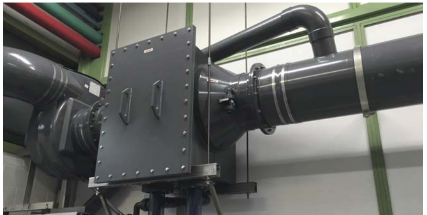
Der Zugang zur Absauganlage für die Wartung muss jederzeit gewährleistet sein.
