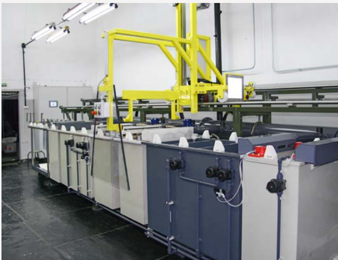
Der Umsetzer (gelb) ist im Sinne des Gesetzes eine Krananlage (im Bild: Chromautomat aus dem Hause ERNE)
