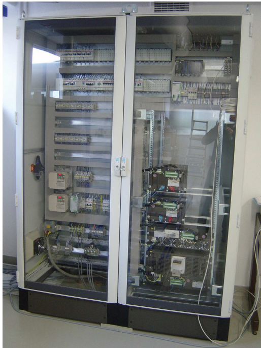
Bild: Steuerschrank mit Gleichrichtereinschubmodulen
