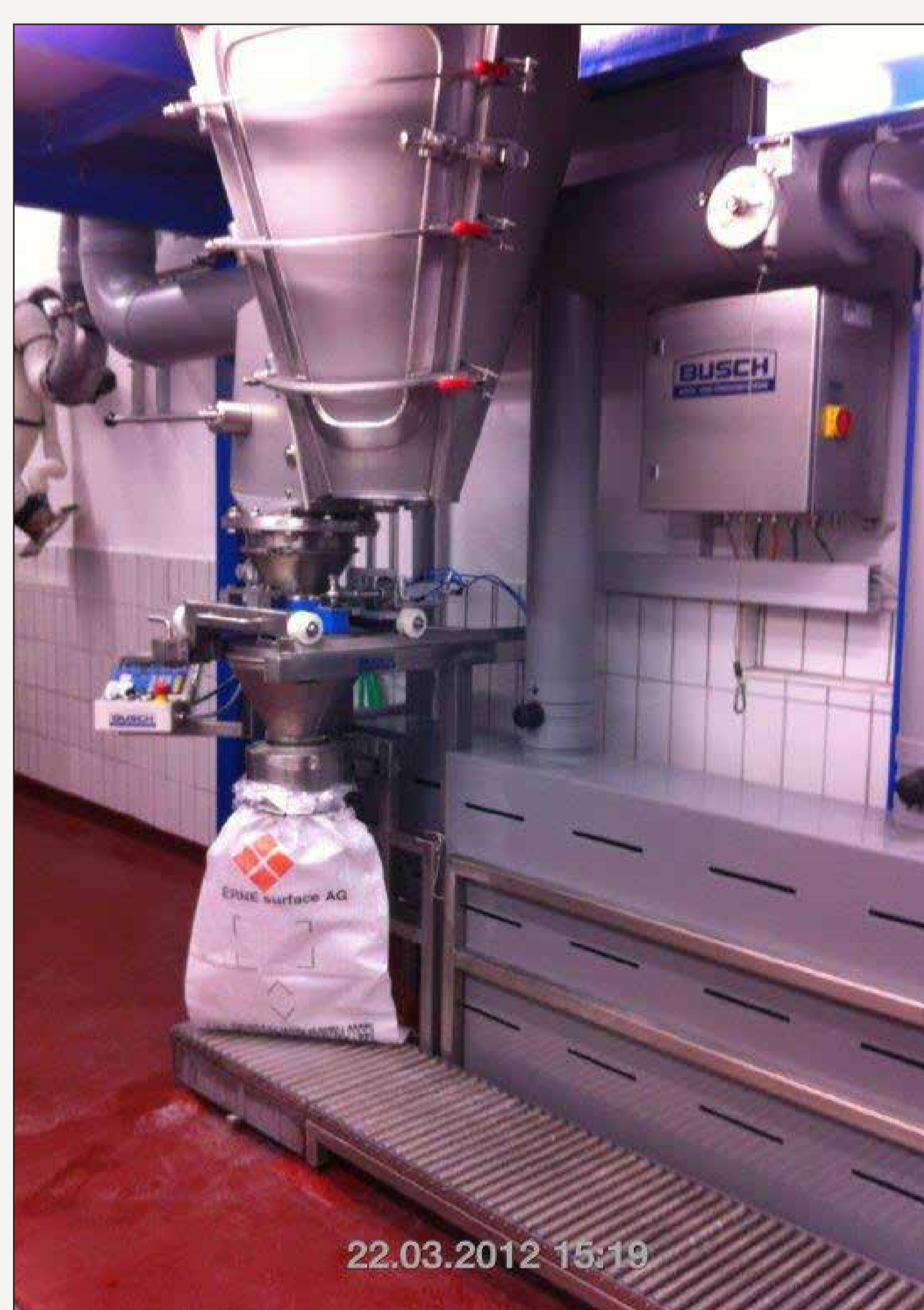
Neue Mischeinrichtung Mischraum M2, 2012
